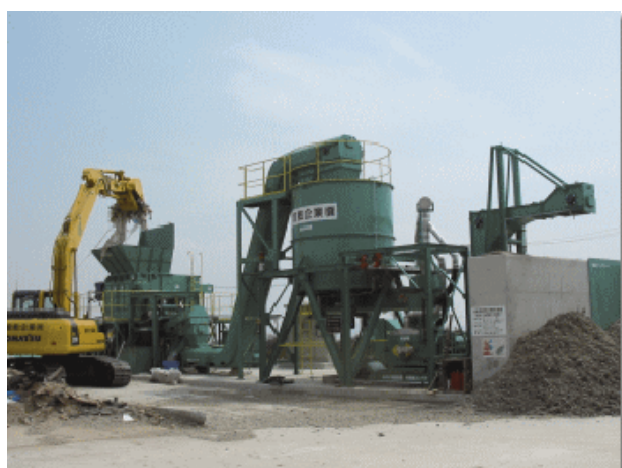
破碎圧縮固化施設
