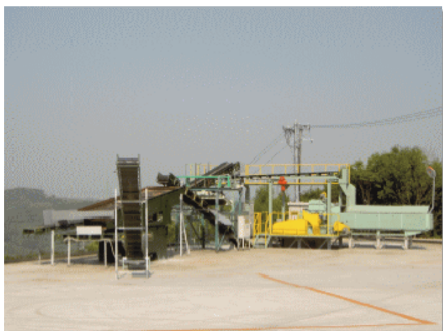
H26年 新設された破碎機
