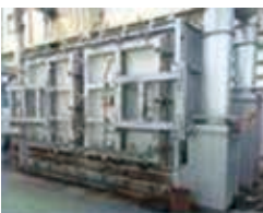
Li-ion電池 リサイクル設備
